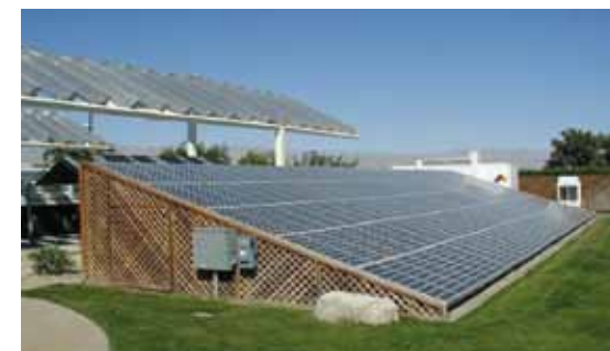
Рис. 6. Размещение солнечных модулей на приусадебном участке
