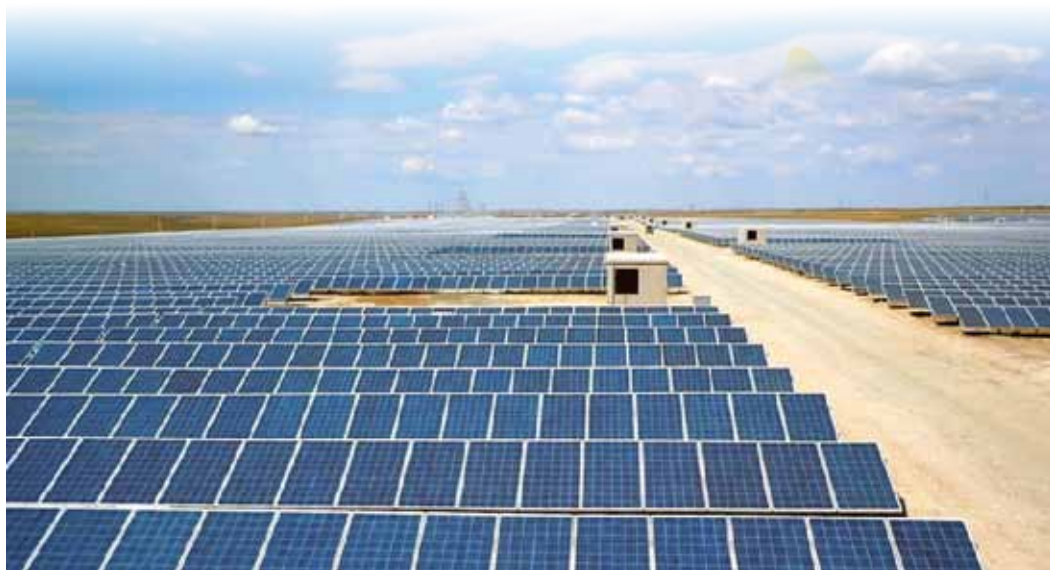
Рис. 8. Крымская солнечная электростанция „Перово“
