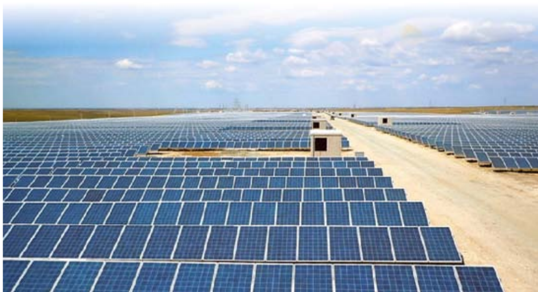
Мал. 8. Кримська сонячна електростанція „Перово”
